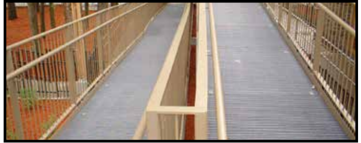
Rampa de entrada a montaña rusa
