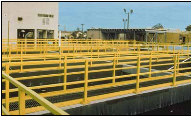
Los barandales de tubo cuadrado fabricados con componentes que son productos Dynaform ofrecen una larga vida útil en el entorno corrosivo de esta planta de tratamiento de aguas residuales.
