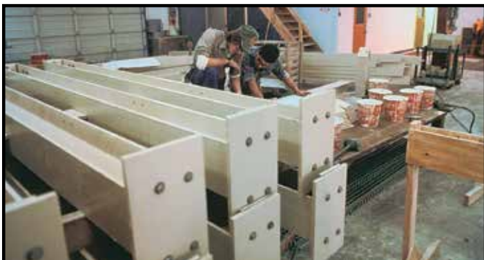
Columnas Dynaform construidas listas para su envío.
